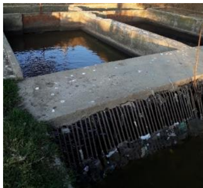
Изображение Н1. Закрытое сооружение для обработки сточных вод
